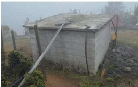
Figura 5.3. Entrada de la cisterna de almacenaje. Se aprecia la manguera principal sujeta mediante un madero (localidad de Potrero Nuevo, La Perla). Fotografía: Víctor Soto
