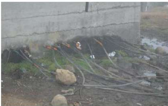
Figura 5.4. Ramificación de mangueras secundarias en la base de la cisterna (localidad de Potrero Nuevo, La Perla). Fotografía: Víctor Soto
